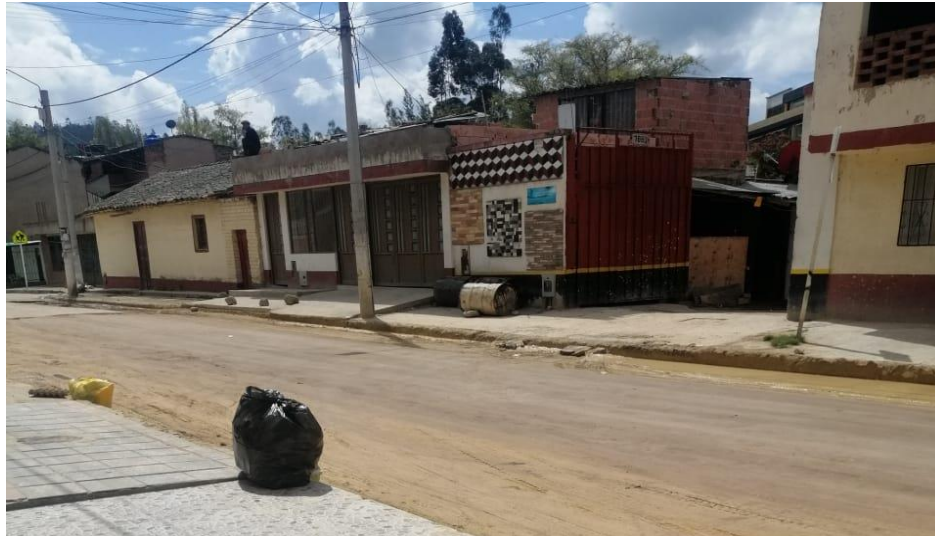
FIGURA 18. Registro fotográfico, del estado del tramo de la vía en condiciones de mejoramiento de la base barrio la paz
