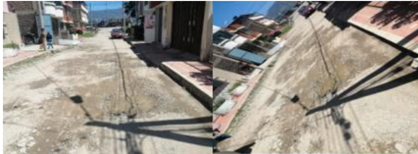
Figura 8. Registro fotográfico, diagnóstico vial, carrera 43 con calle 21 esquina superior.
