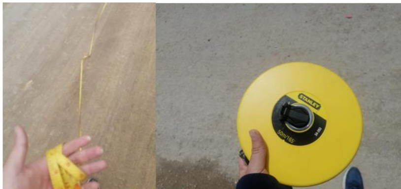
FIGURA 19. Registro fotográfico, del estado del tramo de la vía en condiciones de mejoramiento de la base barrio la Paz
