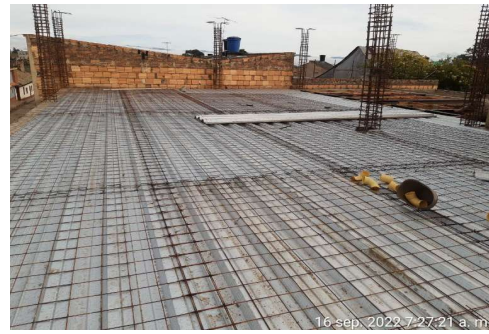
Descripción: instalacion de platina steel y malla electrosoldada para placa de concreto
