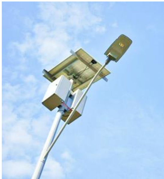
Ilustración 32. Energía limpia en iluminación (vía aeropuerto perales, Ibagué). Fuente Autor
