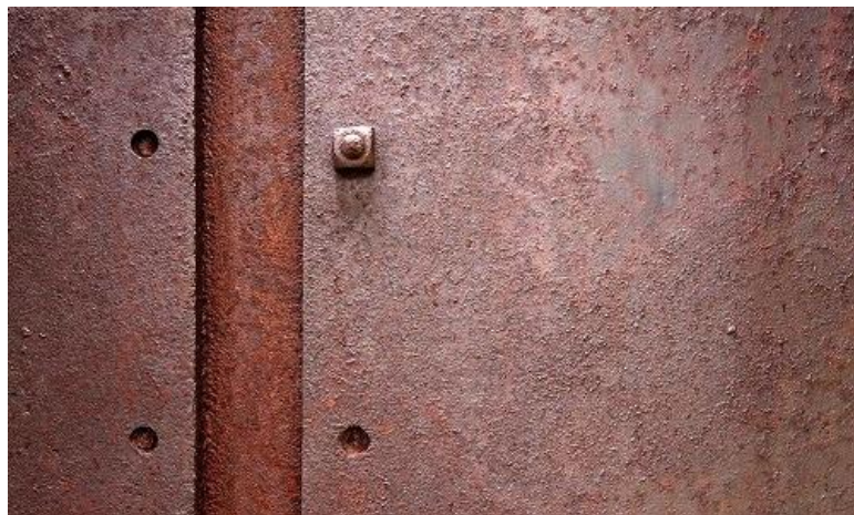
Ilustración 18. Oxidación en metales. Fuente [17]
