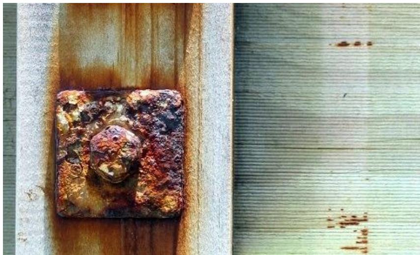
Ilustración 19. Corrosión en metales. Fuente [18]
