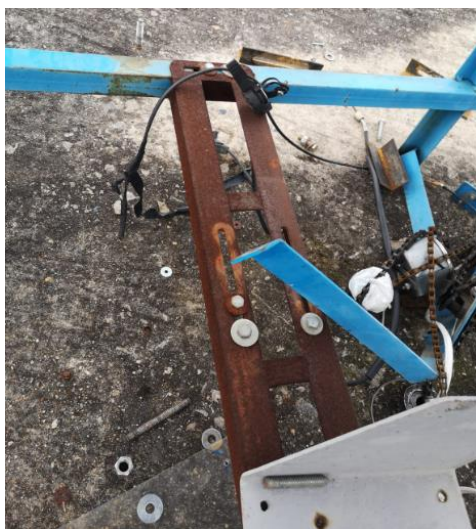
Figura 18. Piezas de la Base con Alta Corrosión
