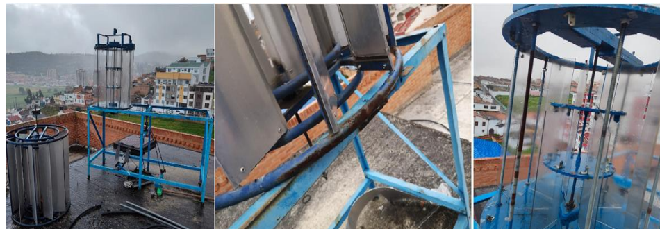
Figura 17. Estado General de la Estructura
