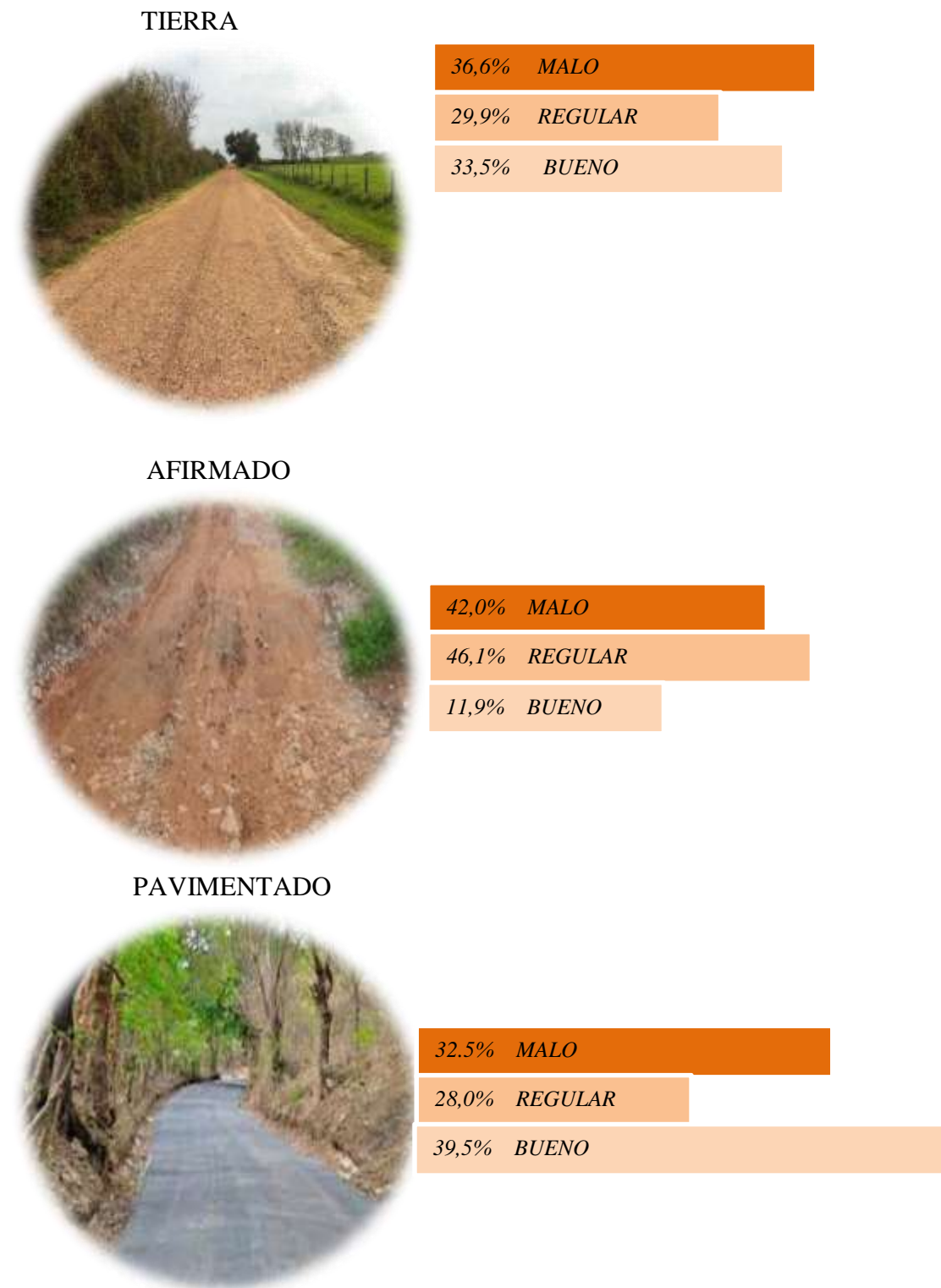
Figura 2. Estado actual carreteras terciarias.
