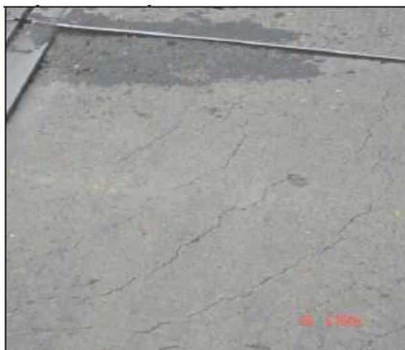
Figura 20. Vista típica de fisuración ligera (FT) (INVIAS, 2006).
