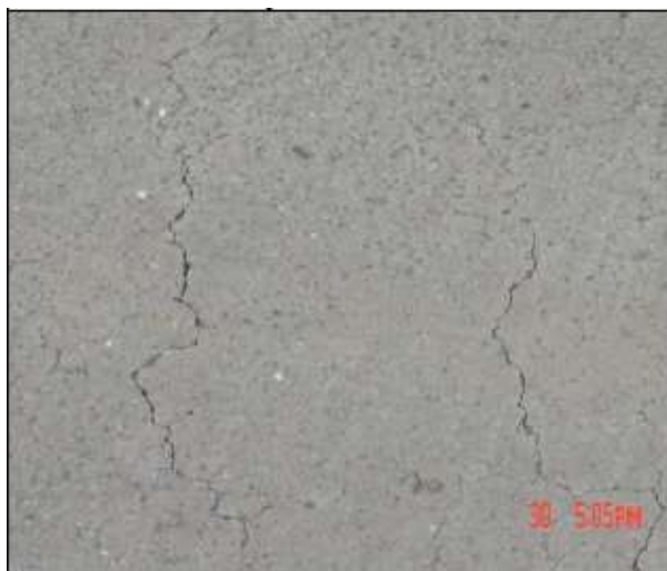
Figura 19. Vista típica de fisuración por retracción o tipo malla (FR) (INVIAS, 2006).
