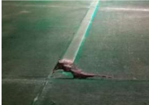
Figura 13. Vista típica de vía con bacheo (BCH) (Elaboración propia).
