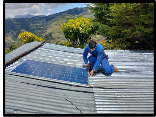
Figura 15. Mantenimiento del panel solar
