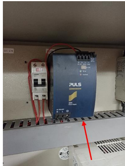
Fig.16. Fuente de alimentación de 24 VDC (Dispositivo de la empresa CYMACOSTA S.A.S.)
