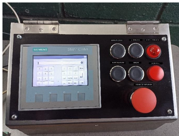
Fig.22 Estación de mando del operador (Dispositivos de la empresa CYMACOSTA S.A.S.)
