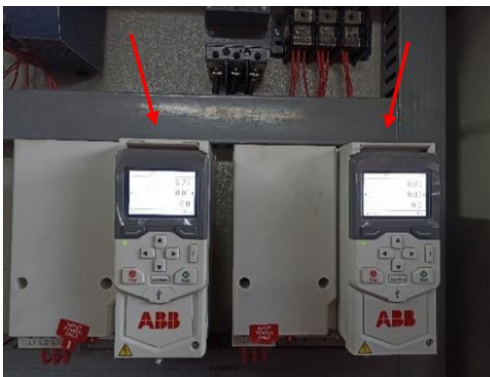
Fig.14. Convertidores de frecuencia ABB ACS355 de 11 kW (Dispositivos de la empresa CYMACOSTA S.A.S.)
