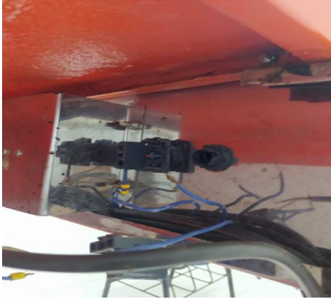
Figuras 14. Circuito Eléctrico en Pulsadores y estigos de los arrancadores en mal estado
