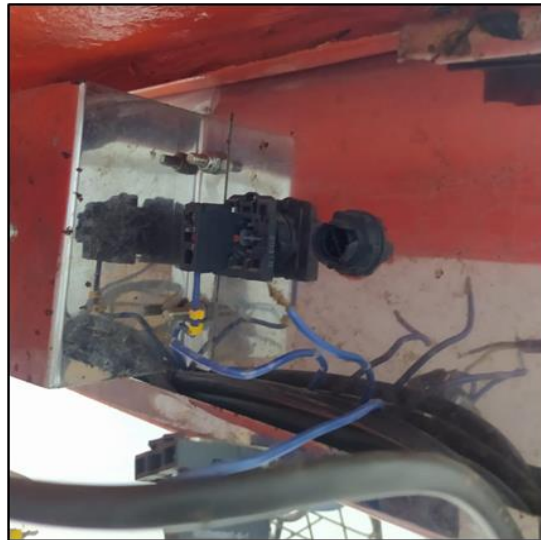
Figura 16. Cableado en mal estado
