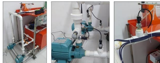
Figura 17. Estado actual de las bombas
