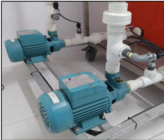
Figura 19. Sistema digital instalado
