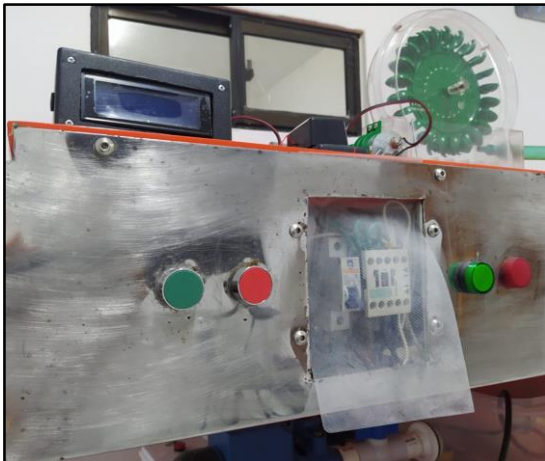
Figura 18. Estado actual del sistema eléctrico de control
