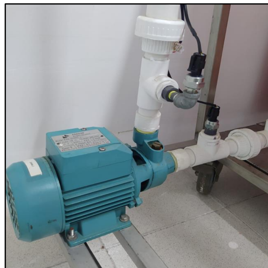
Figura 20. Sistema digital instalado en las bombas
