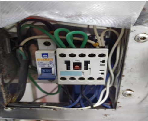
Figura 15. Se tiene un relevador con un breaker instalados sin la normatividad eléctrica.
