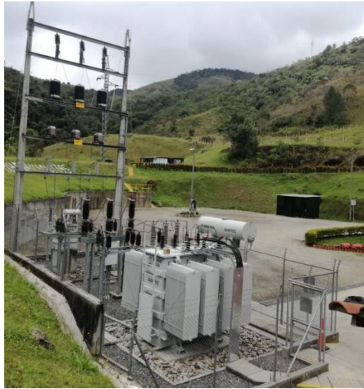
Figura 7. Subestación de generación 44kV
