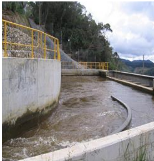
Figura 3. Tanque de carga PCH Guanaquitas
