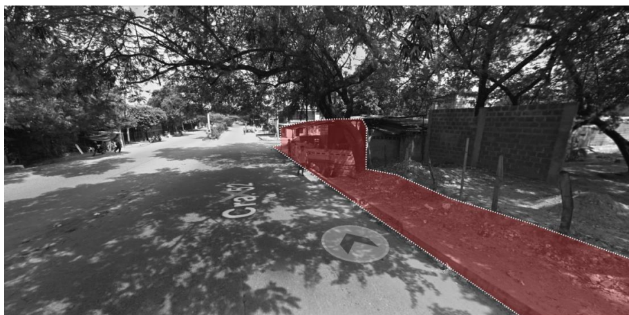
Imagen 3. Deterioro de andenes eje vial carrera 52, barrio Las Palmas
