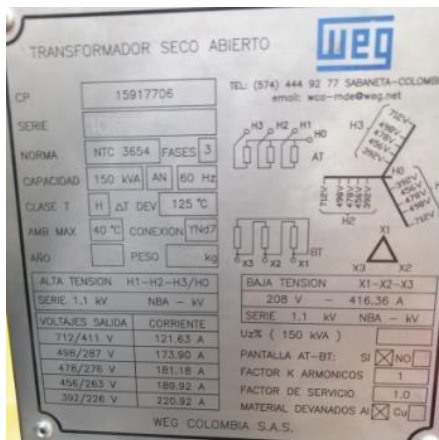
Figura 5-3 Placa de Características Transformador de Potencia
