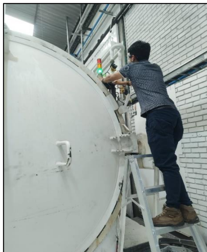
Figura 46. Comprobación de Alarmas.
