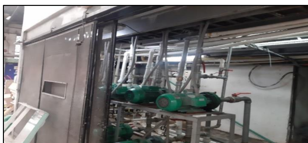
Figura 27. Cuarto de Bombas de la Empresa AGP.
