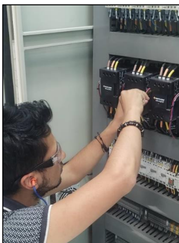
Figura 21. Conexión Watlow DIN-A-MITE en Tablero de Potencia.
