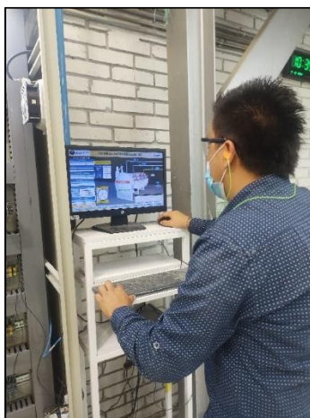
Figura 44. Seguimiento Sistema SCADA.
