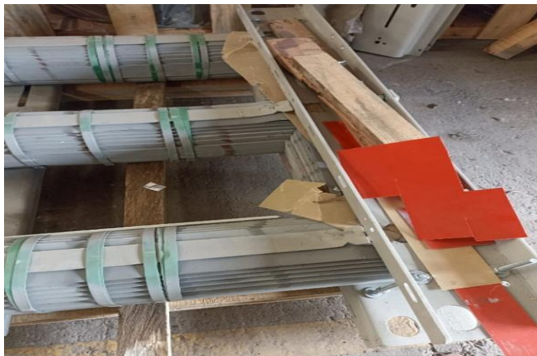
Figura 4. Núcleo de transformador caído. Fuente: Elaboración propia
