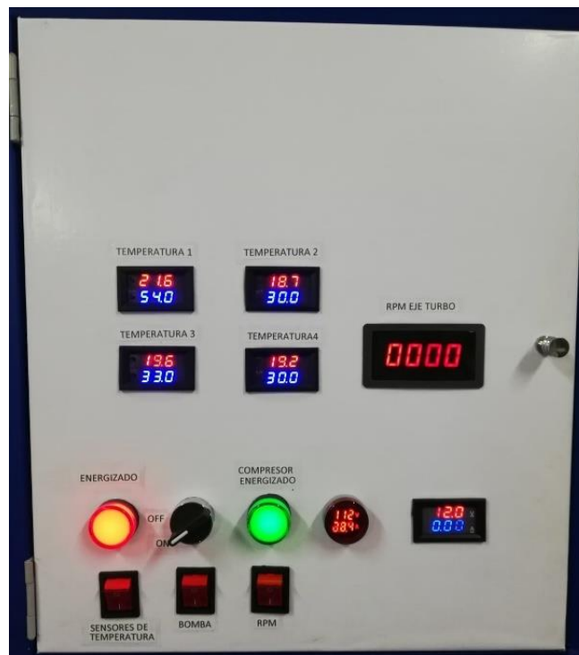
Figura 5-3: Tablero eléctrico y de control energizado
