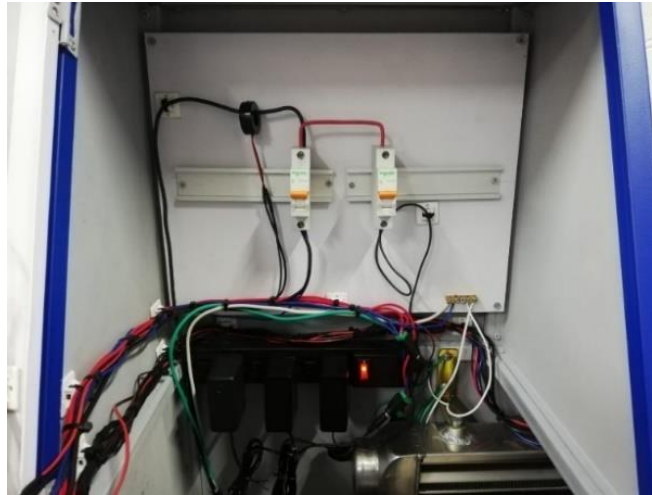
Figura 5-2: Sistema de protección compresor de aire y sistema 12 V
