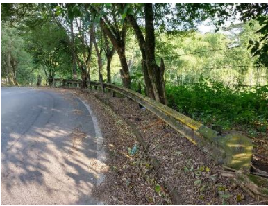
Barrera no abatida, falta pintura
