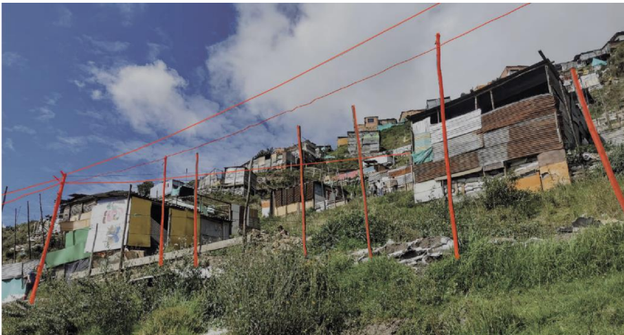
Fotografía 14: Conexiones ilegales de electricidad.
