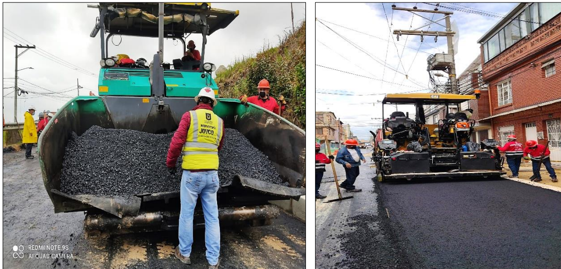
Figura 39. Extendimiento del asfalto en caliente haciendo uso de la maquinaria finisher. Fuente: Propia
