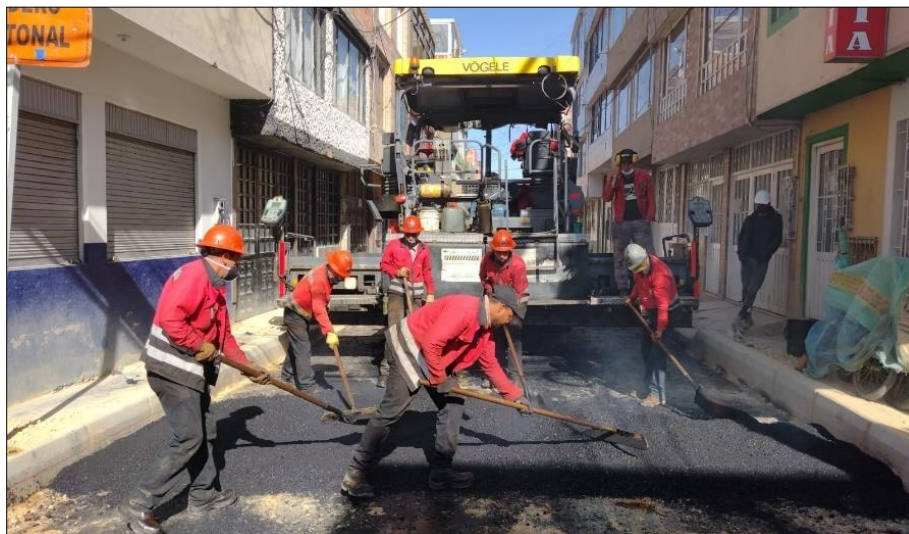
Figura 14. Extensión del asfalto. Fuente: Propia
