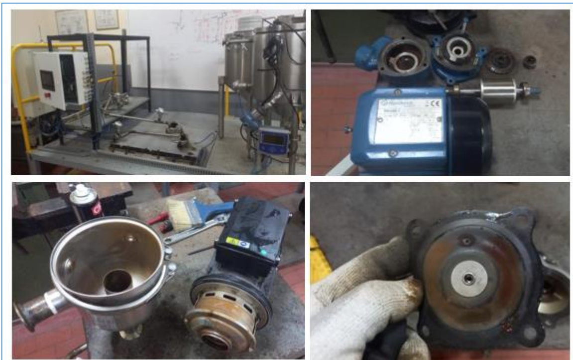
Figura 3- 2. Evidencias de equipos en mal estado
