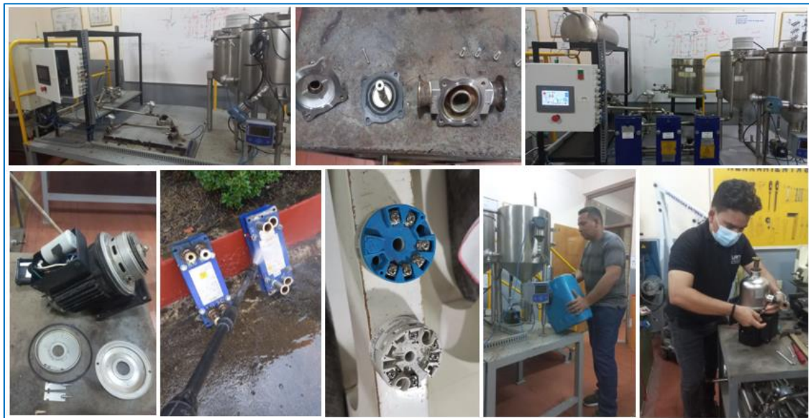
Figura 3-2: Mantenimiento preventivo y correctivo de equipos planta.
