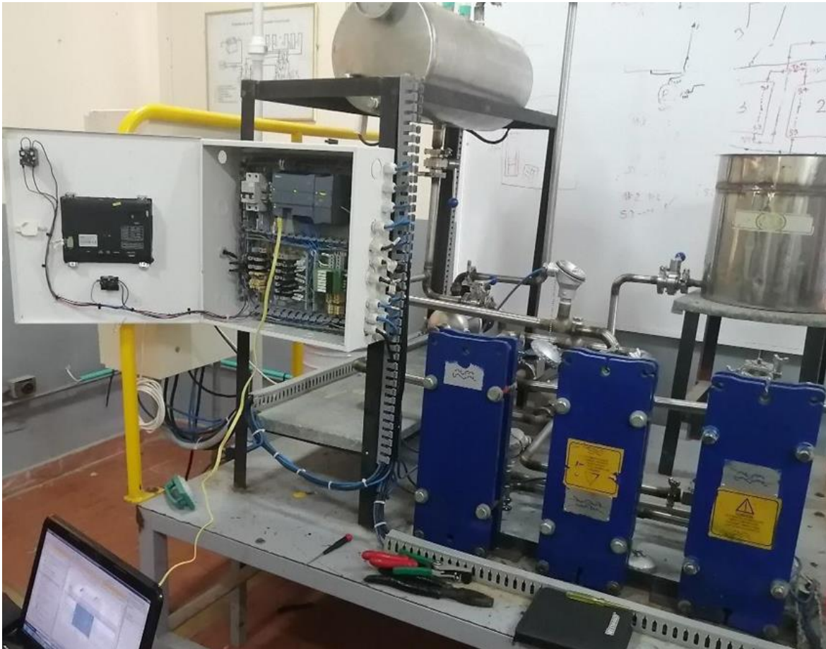
Figura 3-2 Mantenimiento correctivo planta pasteurizadora de leche
