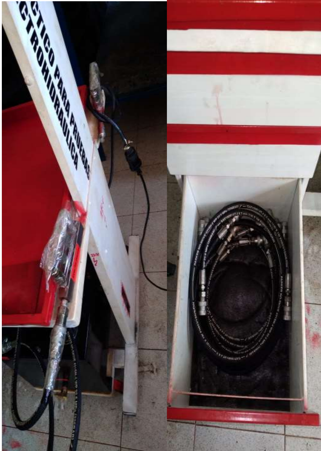
Lado izquierdo Preservación de regletas de conexiones salida de presión de bomba y retorno del aceite hidráulico a tanque; lado derecho organización de líneas hidráulicas en gabinete
