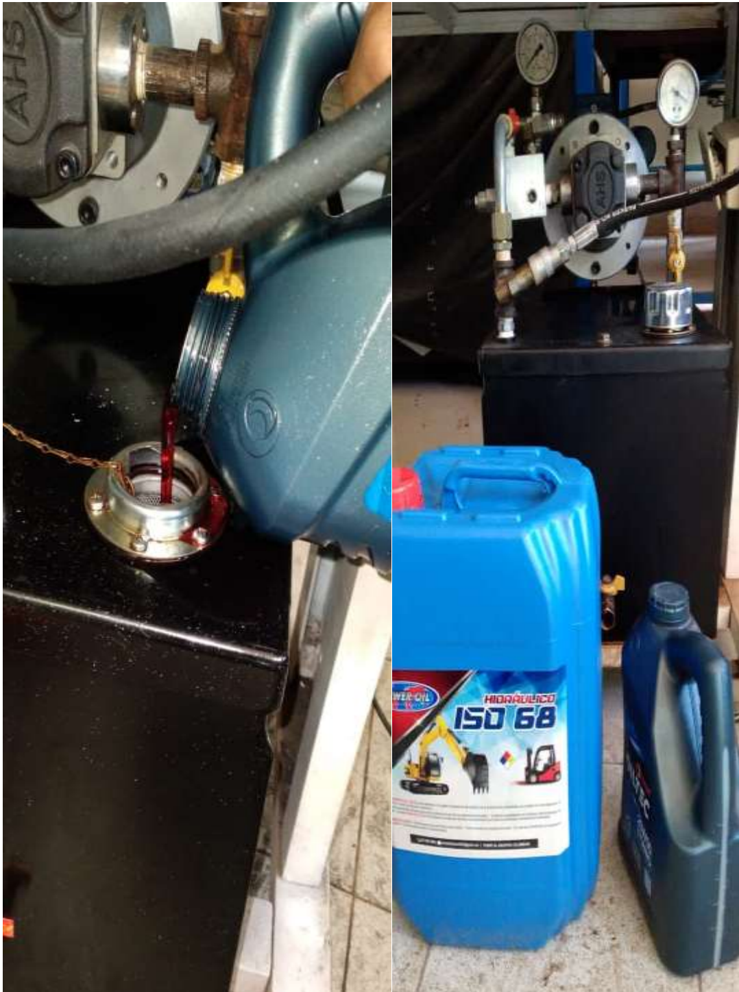
Adición y complete de nivel del aceite hidráulico con ISO 68
