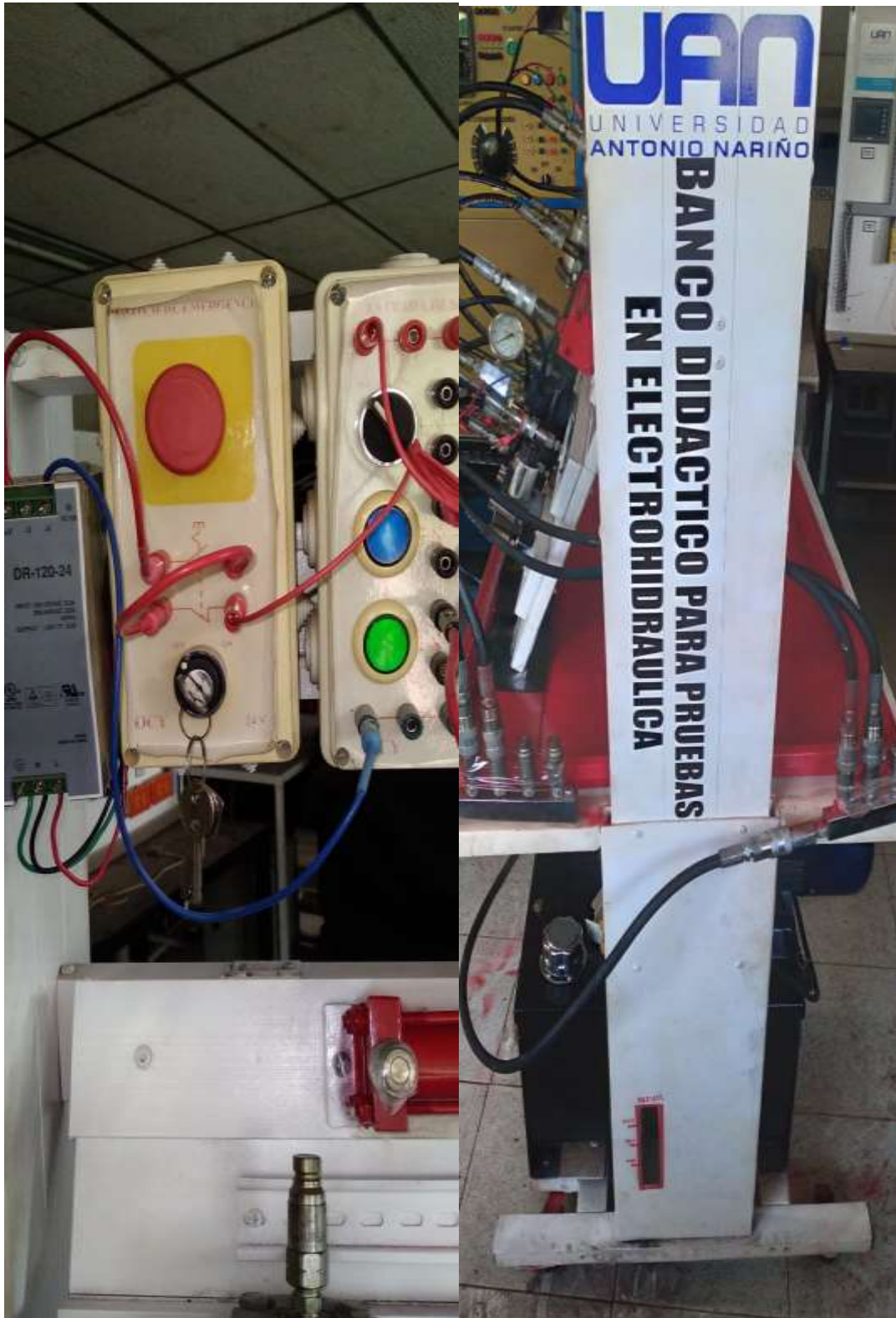
Control eléctrico e identificación del banco hidráulico
