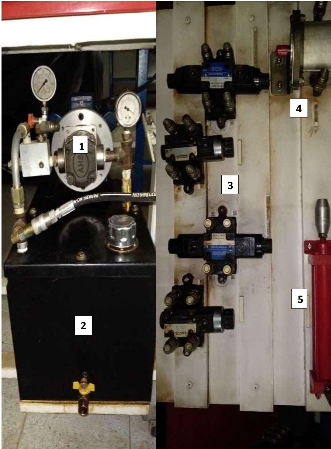
1 Bomba, 2 deposito, 3 valvulas, 4 motor y 5 cilindro del sistema hidraulico
