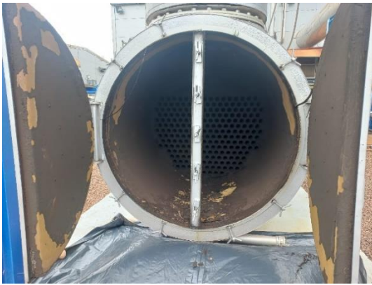
Imagen 1. Fuente propia. Operando con combustible gasoil.
