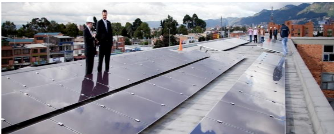
Figura 2: Paneles solares Referencia: Planta fotovoltaica SENA
