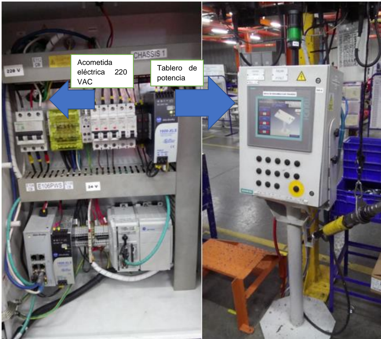
Figura 43. Tablero de potencia
