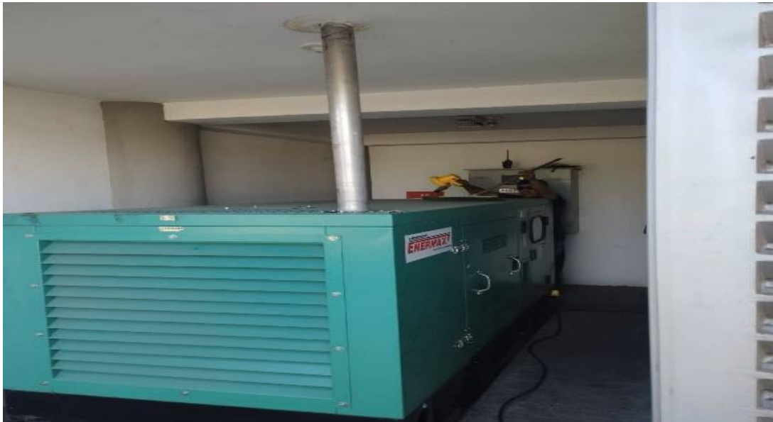
Ilustración 4 Planta eléctrica modulo Regional
