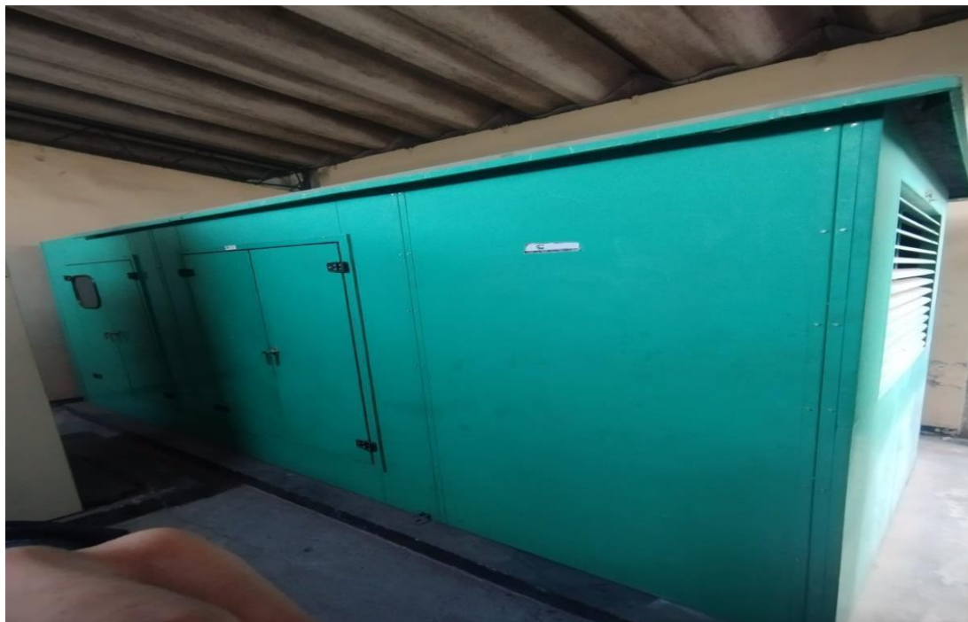
Ilustración 6 Planta eléctrica modulo Copropiedad
