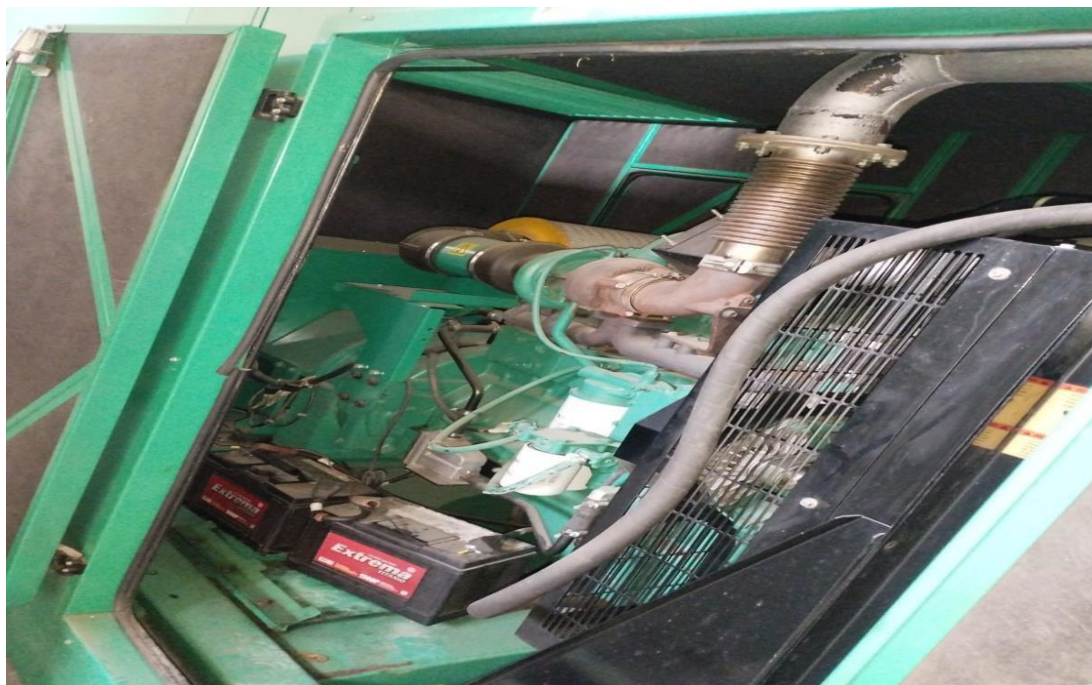
Ilustración 7 Motor planta eléctrica modulo Copropiedad
