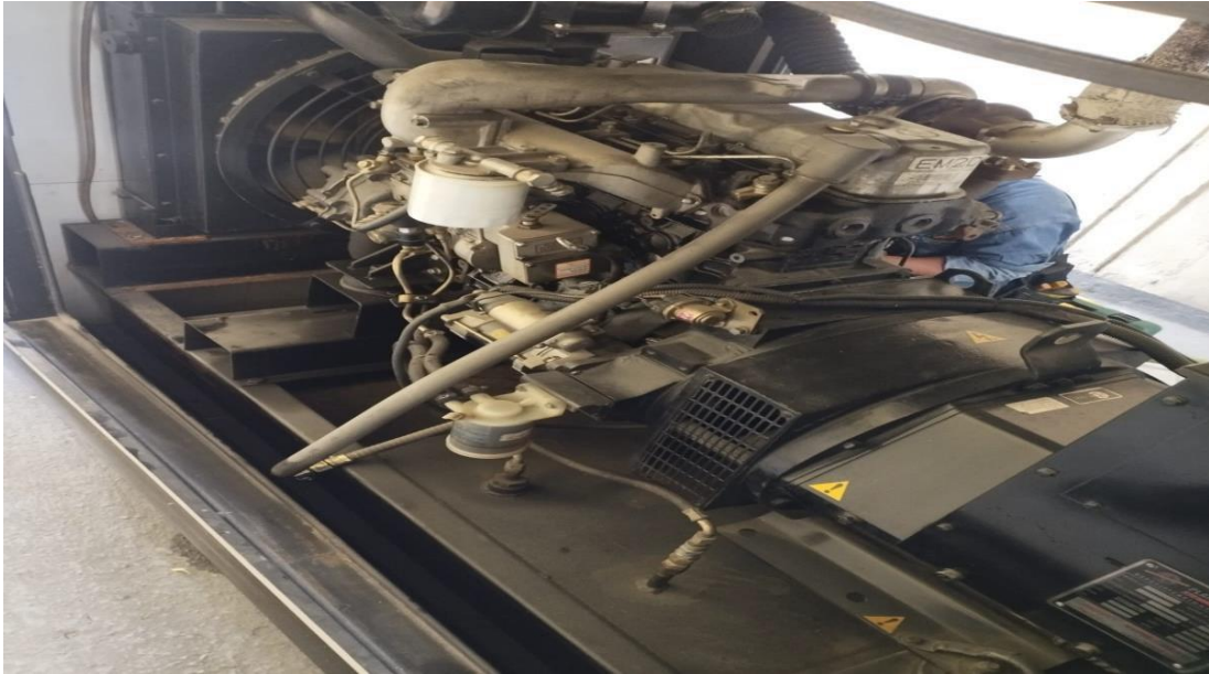
Ilustración 10 Motor planta eléctrica modulo Centenario
