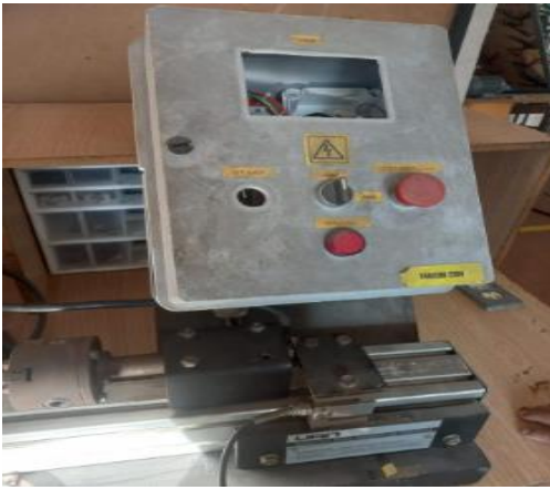
Fig. 6. Gabinete del sistema de control del banco de pruebas de ensayos a torsión, presenta deterioro al interior y exterior y componentes faltantes.
