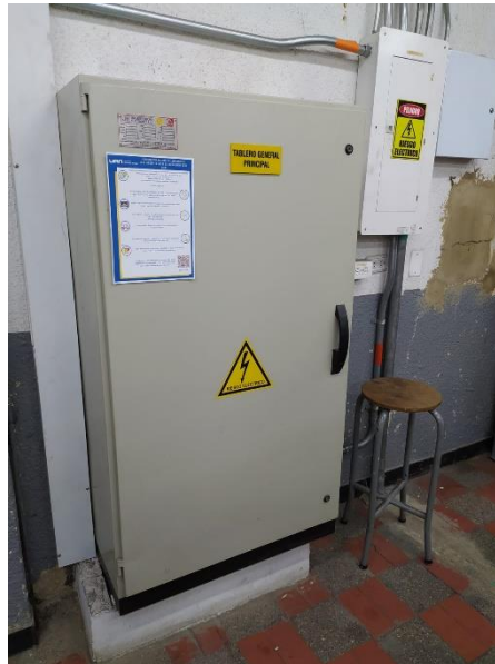
Figura 4-6. Tableros de distribución del taller de mecánica.
