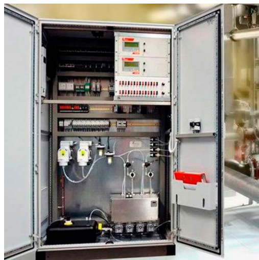
Figura 4-48. Analizador continuo de gases para caldera AyT.
