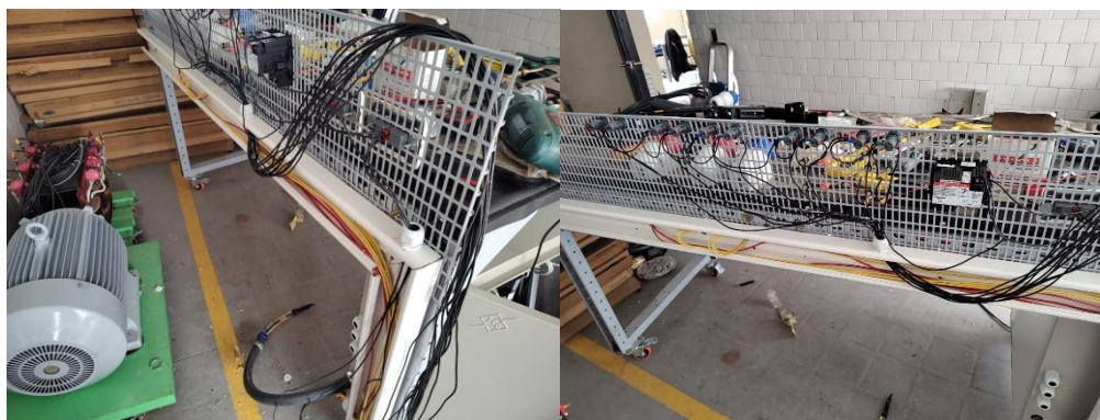
Figura 16. Cableado elementos y circuitos externos al tablero eléctrico.
