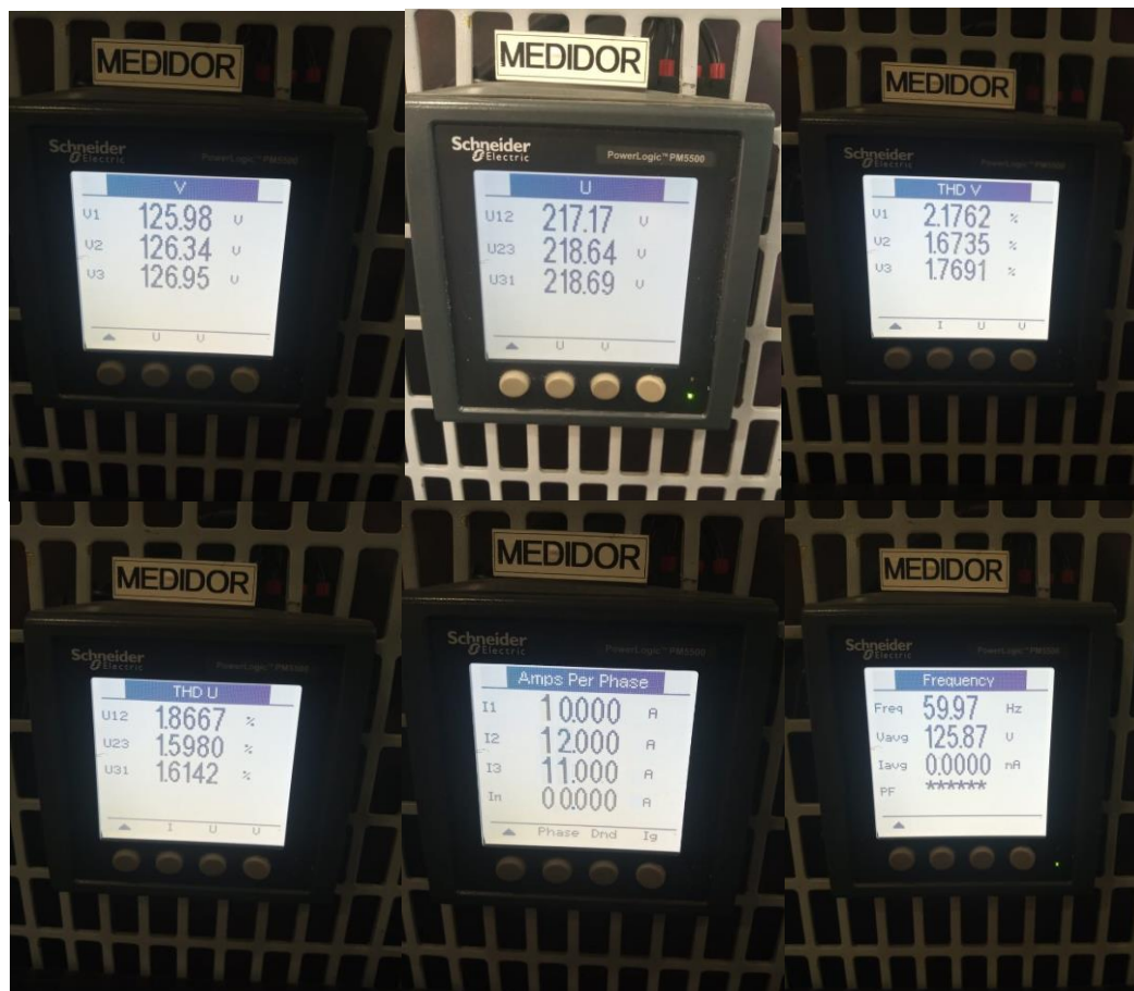
Figura 30. Lectura magnitudes eléctricas por medio del medidor de energía.
