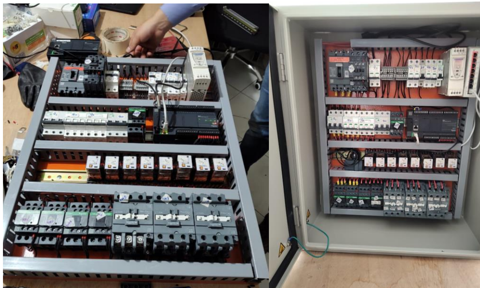
Figura 15. Cableado tablero eléctrico.
