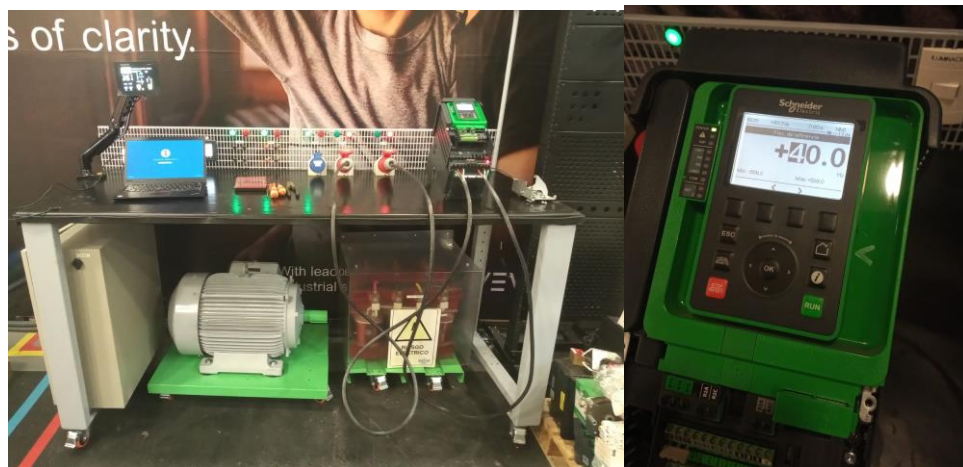
Figura 29. Conexión y arranque de variador de velocidad Altivar 930.
