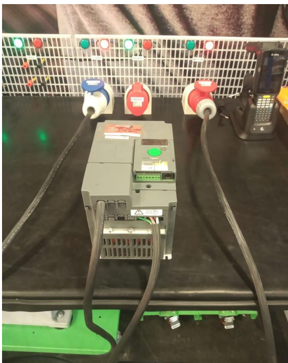
Figura 31. Conexión variador de velocidad Altivar 310
