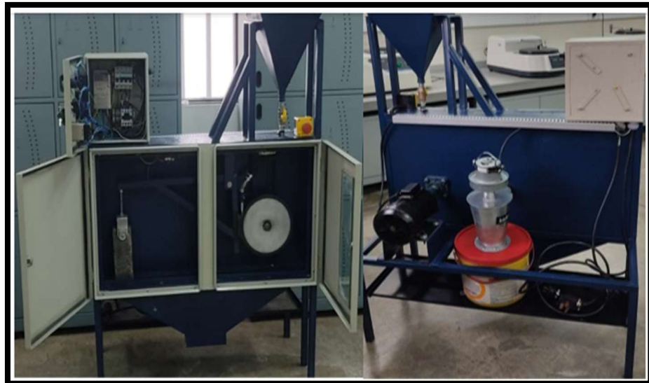
Figura 67 Control eléctrico y conexiones terminada
