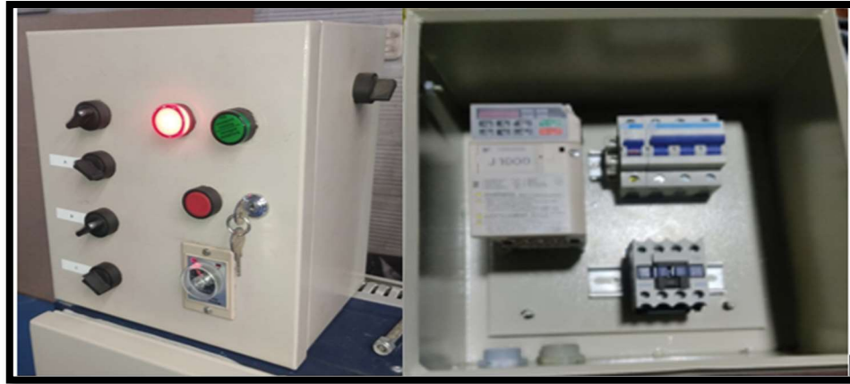
Figura 66 Tablero de control
