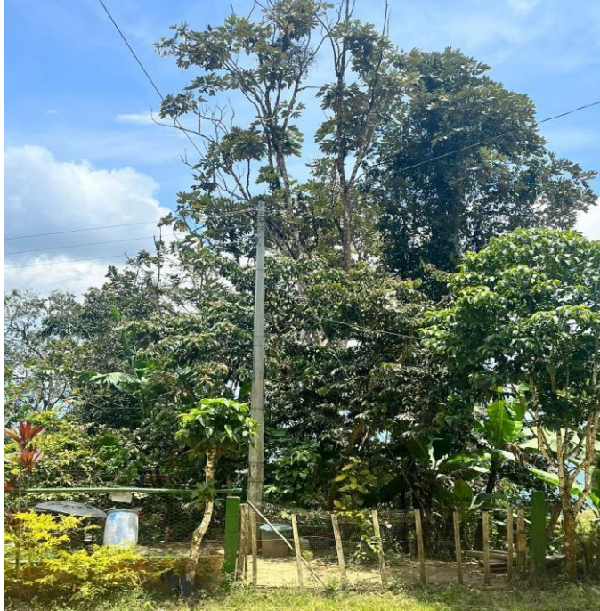
Fotografía 2: Poste de la luz.
