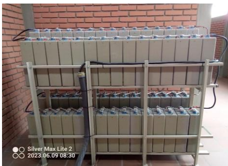
Figura 9. Banco de baterías.
