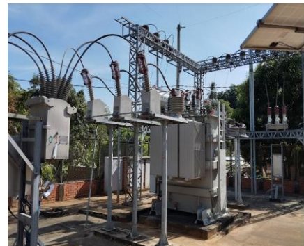
Figura 6. Componentes de potencia de la Subestación La Culebra.
