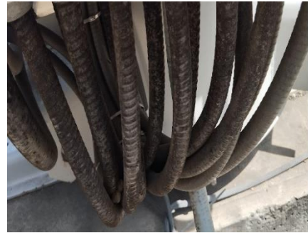
Figura 5. Tubos y canalizaciones.
