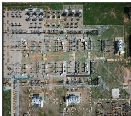
Figura 1. Subestación eléctrica la Culebra.
