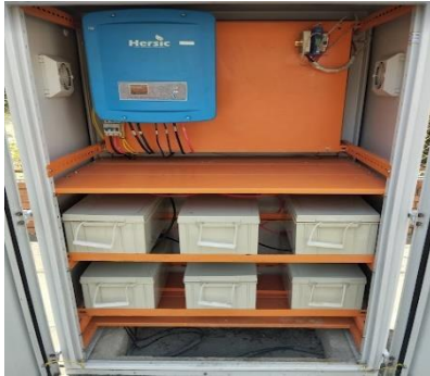
Figura 3. Inversor y baterías.
