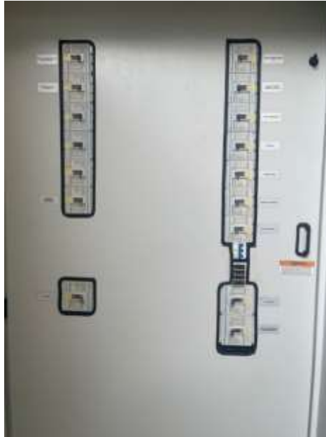
Figura 17. Tablero de Distribución
