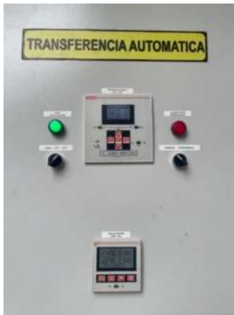
Figura 18. Sistema de Transferencia Automática
