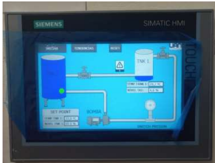
Figura 6- 3. Pruebas de funcionamiento del banco de entrenamiento (Apagado)
