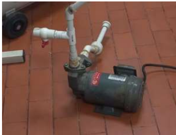
Figura 5- 4. Bomba centrífuga en mal estado
