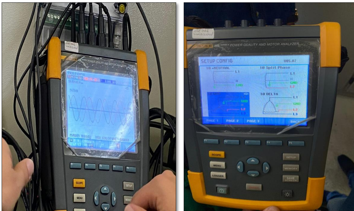
Figura 4 - Analizador de redes en funcionamiento
