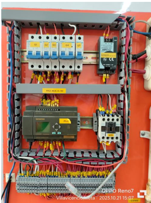
Fig. 5. Vista frontal Controlador lógico Programable
