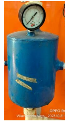
Fig. 12. Tanque pulmón de presión.
