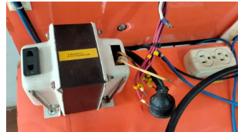
Fig. 13. Transformador elevador 110V/220V
