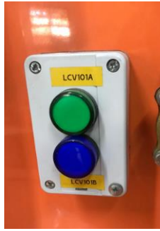
Fig. 9. Indicadores luminosos de activación de las electroválvulas.
