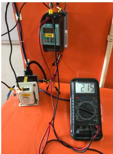
Fig. 21. Pruebas de funcionamiento transformador/variador
