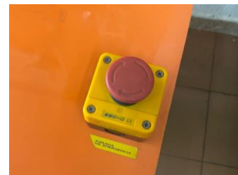
Fig. 19. Parada de emergencia restaurada
