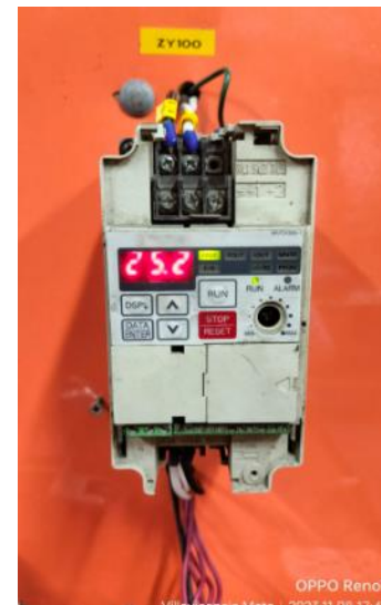
Fig. 23. Variador de frecuencia CIMR-J7AA20P2 YASKAWA
