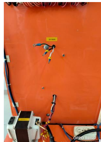
Fig. 14. No presencia del variador de frecuencia.
