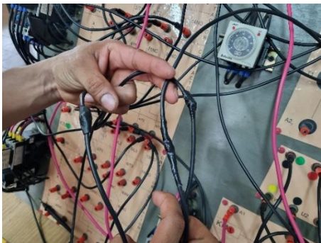
Fig.10. conductor eléctrico del banco de control didáctico electromecánico de contactores para arranques de motores eléctricos trifásicos.
