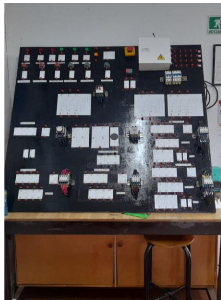
Fig27 Restauración del banco de control didáctico electromecánico de contactores para arranques de motores eléctricos trifásicos.
