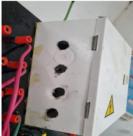
Fig.14. tablero eléctrico del banco de control didáctico electromecánico de contactores para arranques de motores eléctricos trifásicos.
