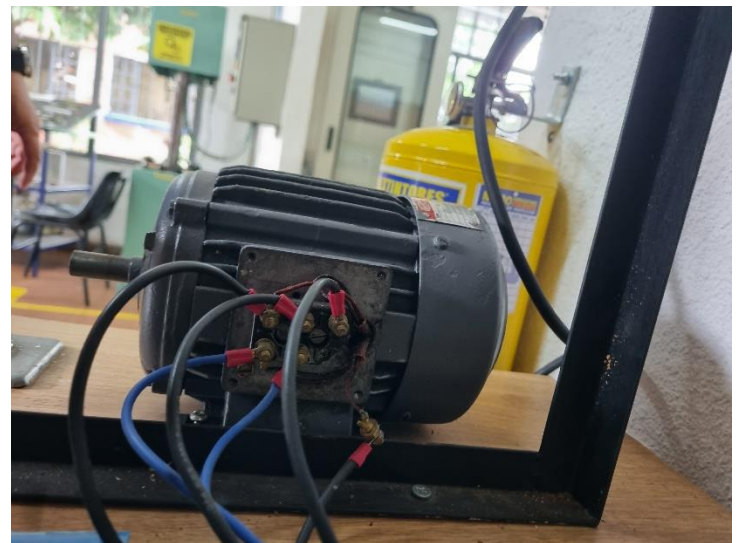
Fig.2 motor del banco de control didáctico electromecánico de contactores para arranques de motores eléctricos trifásicos.
