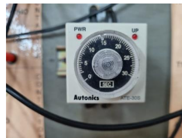
Fig.13. temporizador del banco de control didáctico electromecánico de contactores para arranques de motores eléctricos trifásicos.
