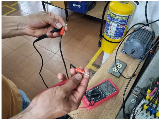
Fig.8. conductor eléctrico. prueba continuidad del banco de control didáctico electromecánico de contactores para arranques de motores eléctricos trifásicos.
