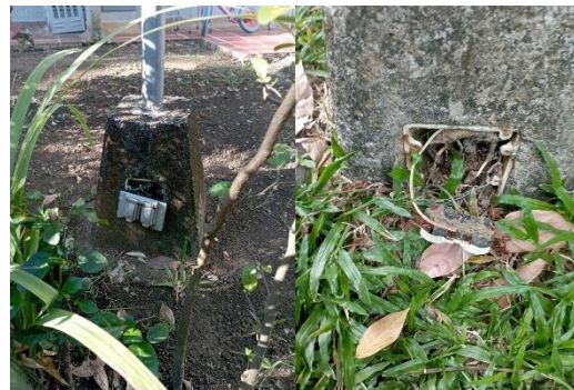
Fig. 4 cajas de tomas corrientes
