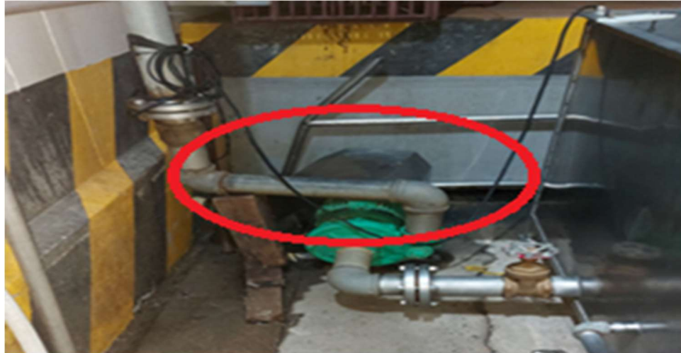
Figura 4. 9 Dos codos que conectan entrada y salida de la bomba.
