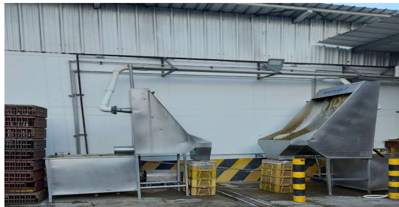
Figura 4. 5 Cribas para el filtrado del agua de bombeo y reutilización en el proceso
