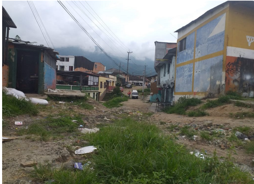
Figura 29 Vía calle 24 y su estado actual (Forero, 2019)
