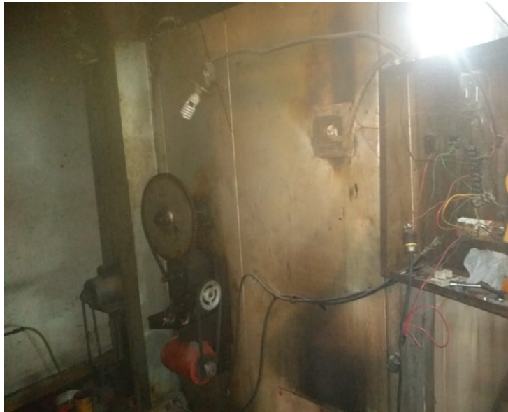
Figura 8. Cuarto de máquinas.
