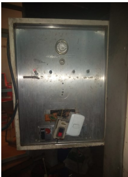
Figura 6. Tablero eléctrico del horno.
