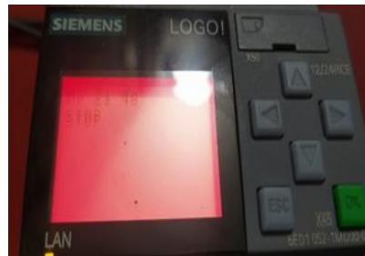
Fig. 15. Pantalla PLC parada del equipo
