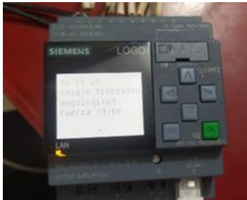
Fig. 11. Pantalla PLC con mensaje "ensayo culminado"
