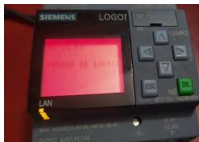
Fig. 16. Pantalla PLC parada de emergencia
