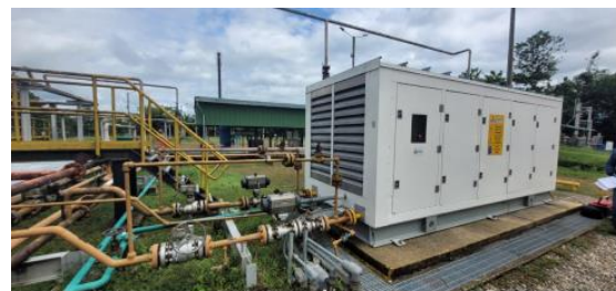
Figura 1. Compresor ARIEL planta Tibú
